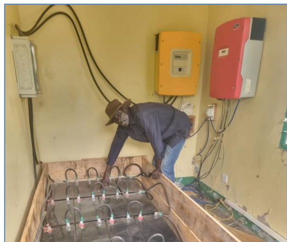
Elektriker Harry Baru ist seit vielen Jahren auch für die Wartung der PV Anlagen und Batterien zuständig.
