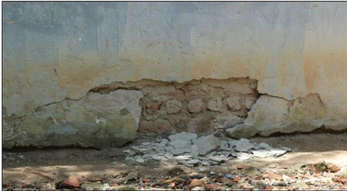
Das Klima setzt den Gebäuden zu
